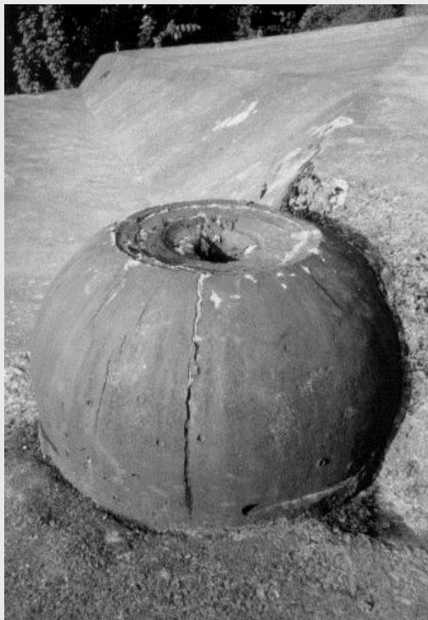
Бетонный купол в форте Эбен-Эмаэль после взрыва кумулятивного заряда
